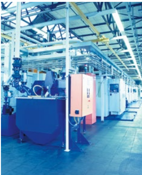
Rückpumpstation zur Versorgung einer Transferstraße
